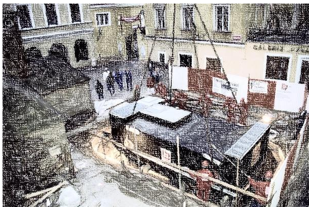
Рисунок 11 Подстанция заглубленного типа
